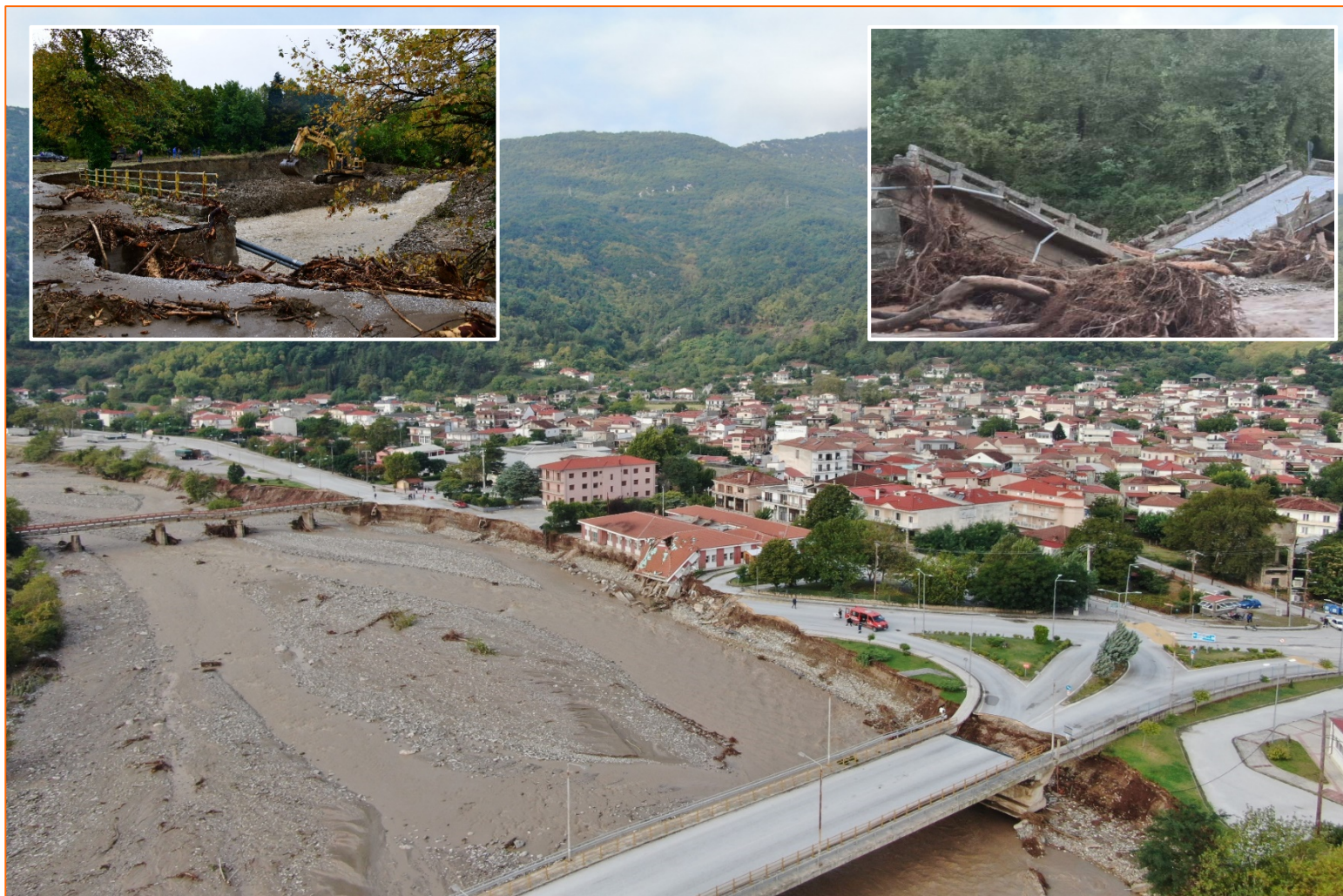
Επιπτώσεις σε γέφυρες και στο Κέντρο Υγείας στην περιοχή Μουζακίου
