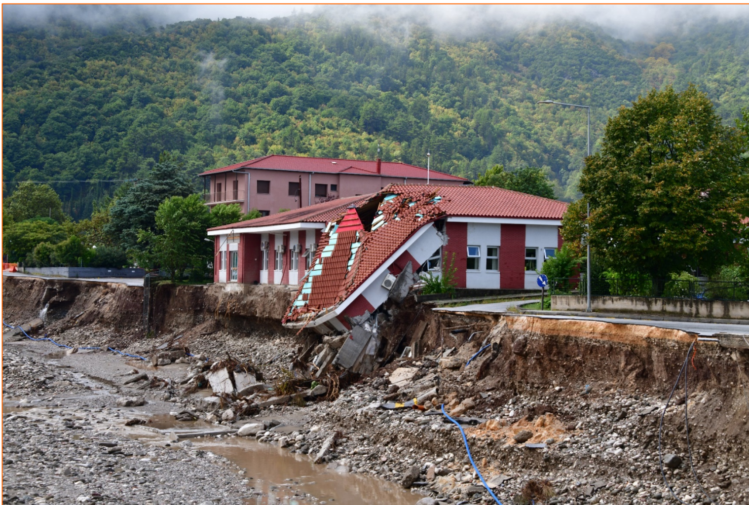
Επιπτώσεις στο Κέντρο Υγείας στην περιοχή Μουζακίου
